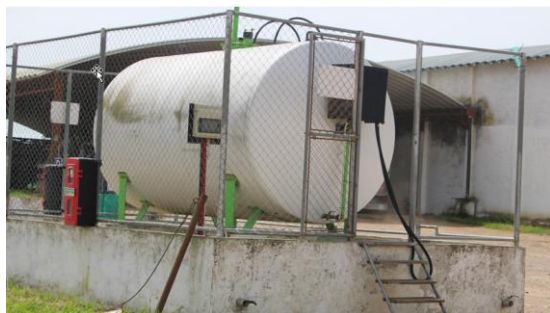
Figura 12 - Depósito de combustível (D1)
